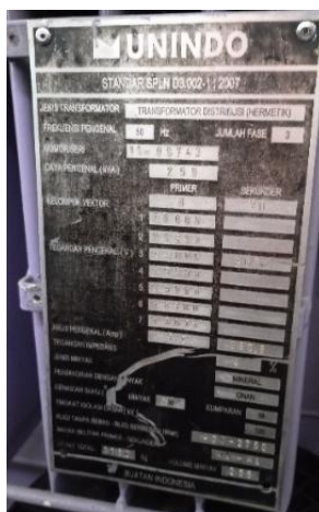
Gambar 2. Spesifikasi nameplate transformator
