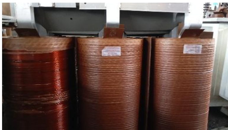
Gambar 3. Kondisi belitan fasa C setelah dilakukan pembongkaran
